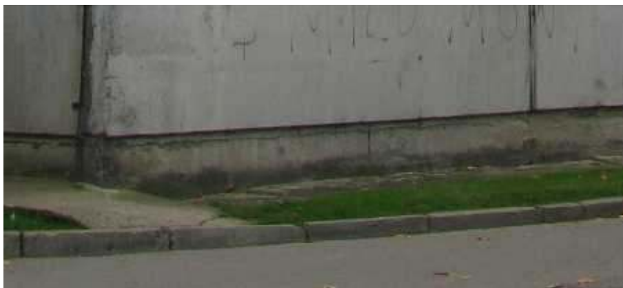
4.1.6.att. Apmale saplaisājusī un deformējusies pie ēkas ZA stūra.
