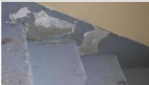
4.10.3. Kāpņu sienas apdare mitruma bojāta.
