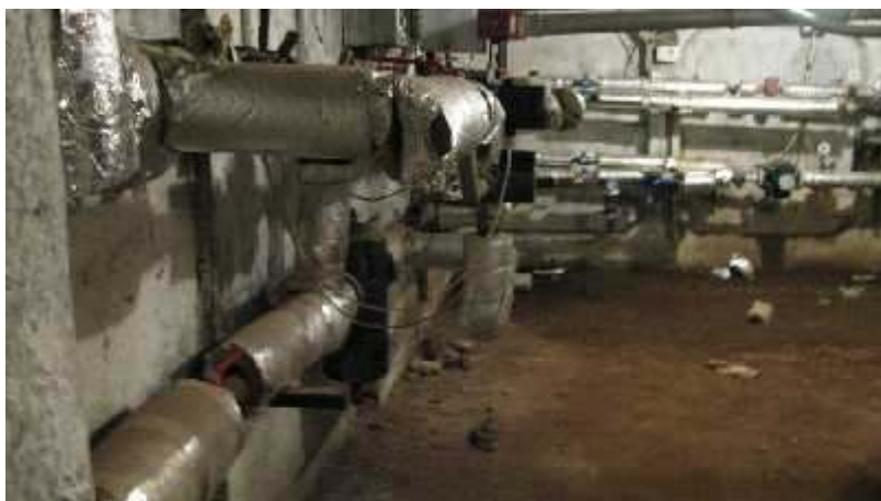
5.4.1.att. Siltummezgls ēkas pagrabstāvē.
