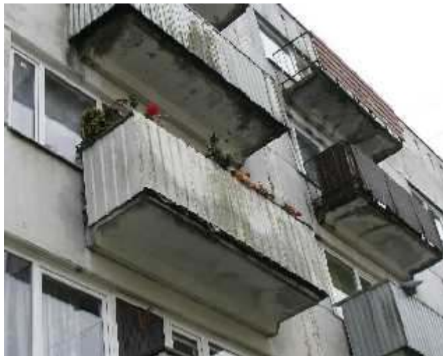
4.9.1.att. Balkonu plātnes ar mitruma plankumiem un betona aizsargkārtas izdrupumiem.
