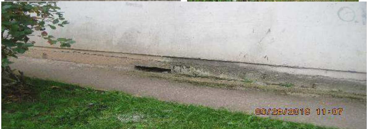
Cokla daļai pa perimetru nepieciešama hidroizolācija un siltināšana, izbūvējot betona apmali un lietus ūdeņu novadīšanu no pamatiem.
