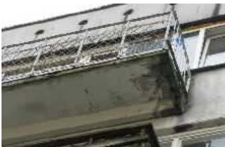
4.9.2.att. Balkona plātnes stiegrojumam izdrupusi betona aizsargkārtā.
