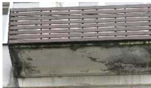
4.9.3.att. Betona aizsargkārtas bojājumi balkona plātnē.
