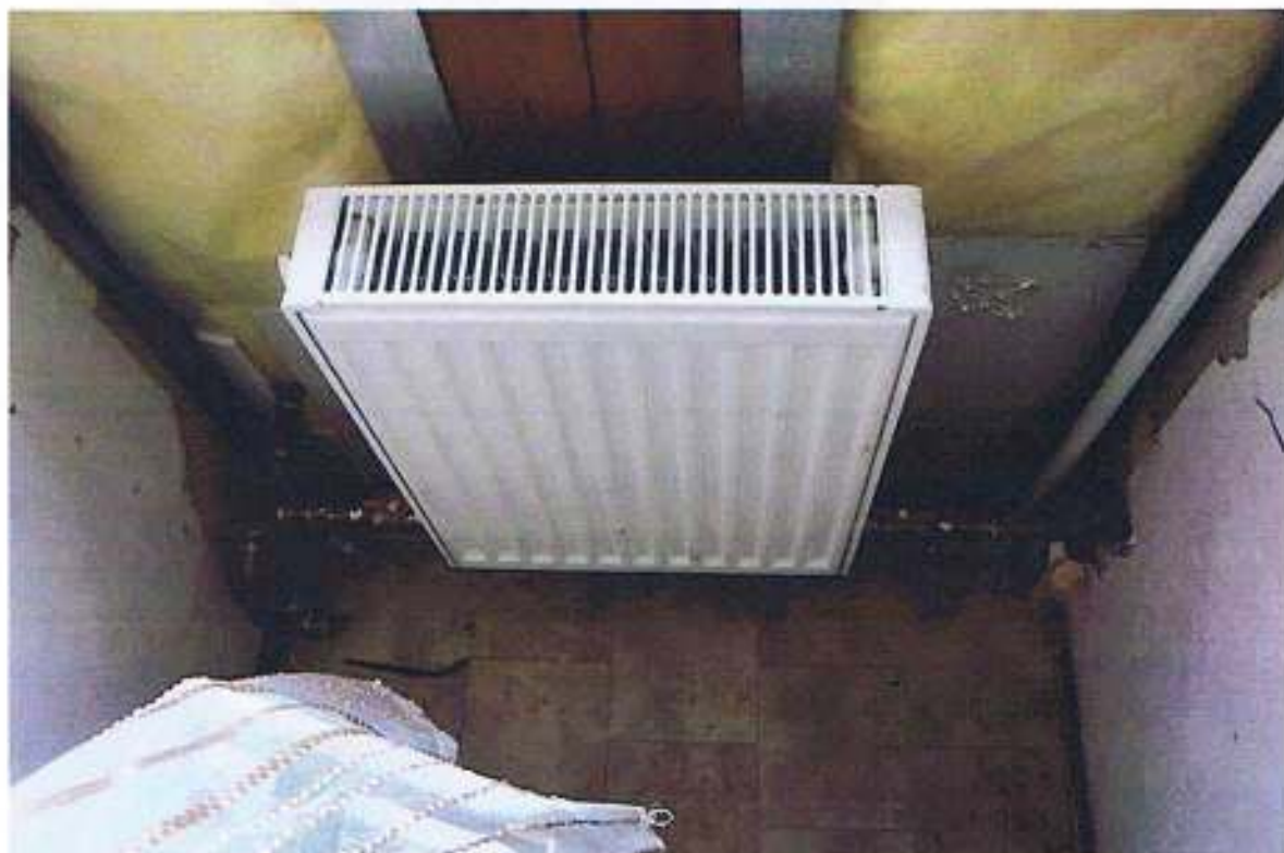
F-39; Radiators dzīvoklī Nr.6. A bloks
