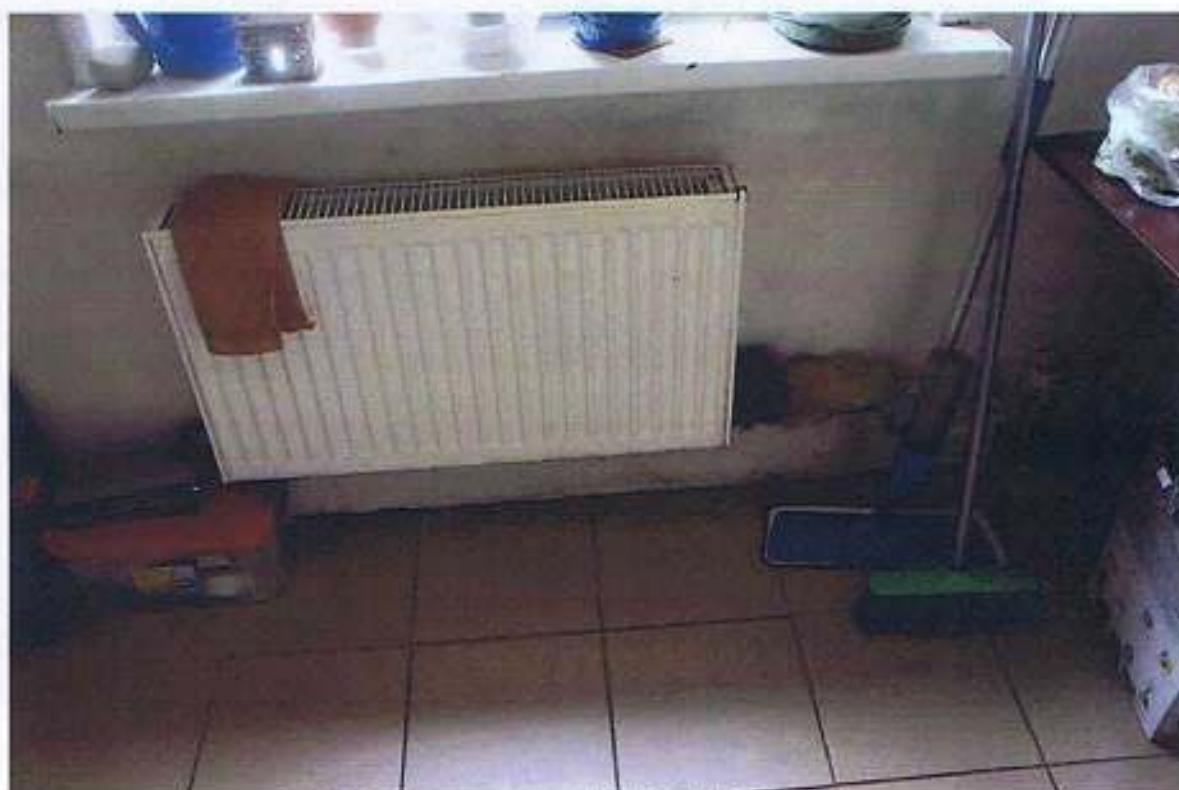
F-36; Radiators dzīvoklī Nr.5. A bloks
