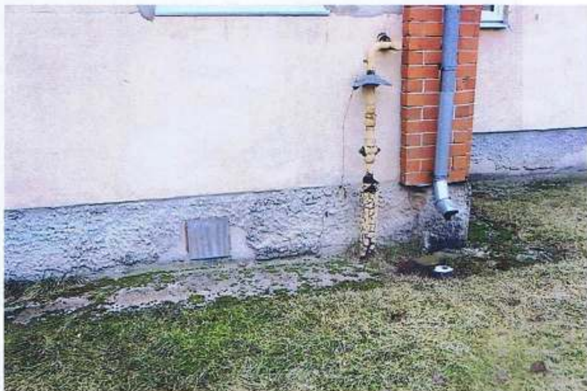
F-23; Ēkas cokola fragments ar iesēdušos apmali. A bloks
