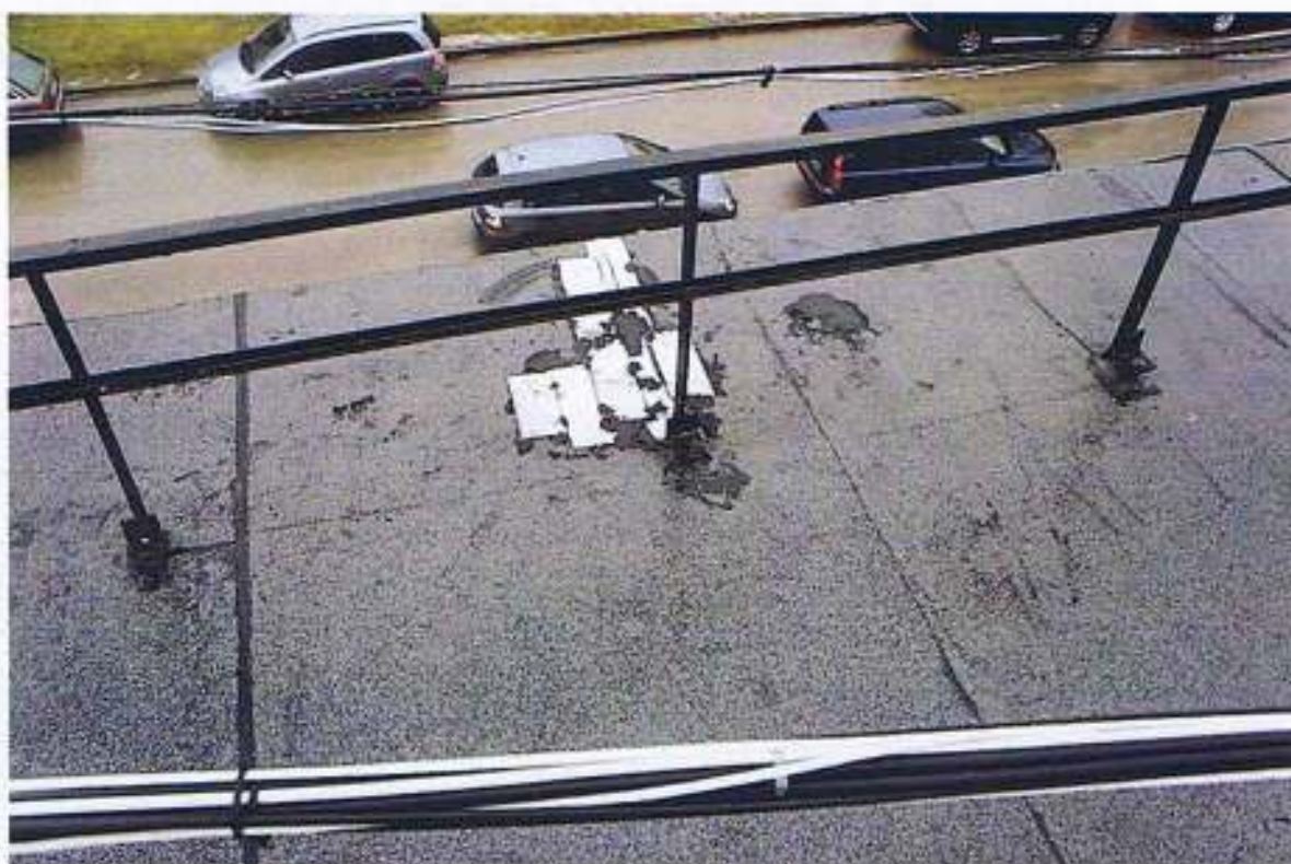
F-46; Jumta fragments ar bojātu segumu. C bloks
