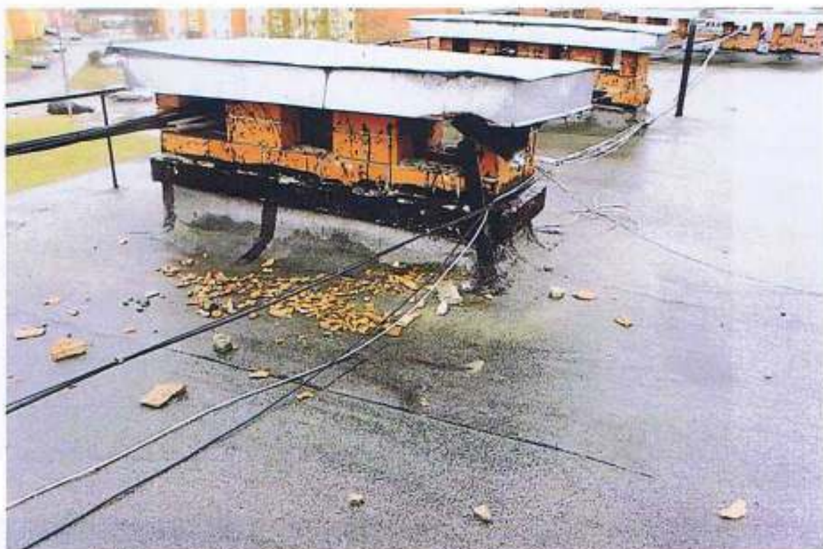
F-47; Jumta fragments ar bojātu ventilācijas izvadu. D bloks
